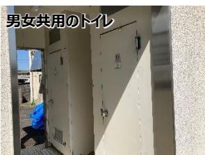
衛生設備の老朽化
